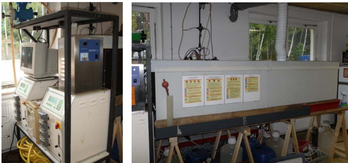
Abbildung 13: Pilotreaktor zur biologisch-oxidativen Prozesswasserreinigung im Baulabor Zernsdorf.
